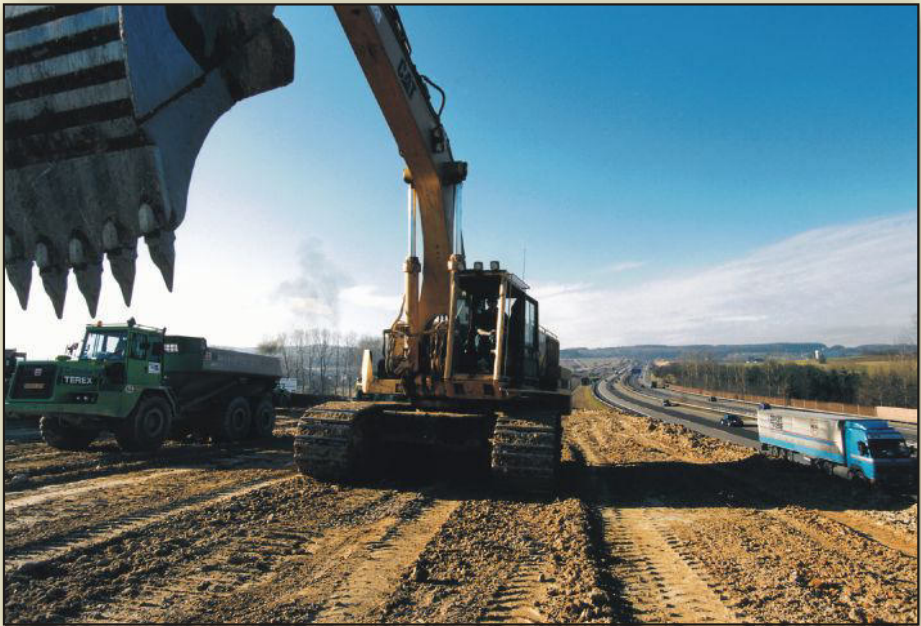
Verdichtung - eine Folge häufiger Befahrungen
